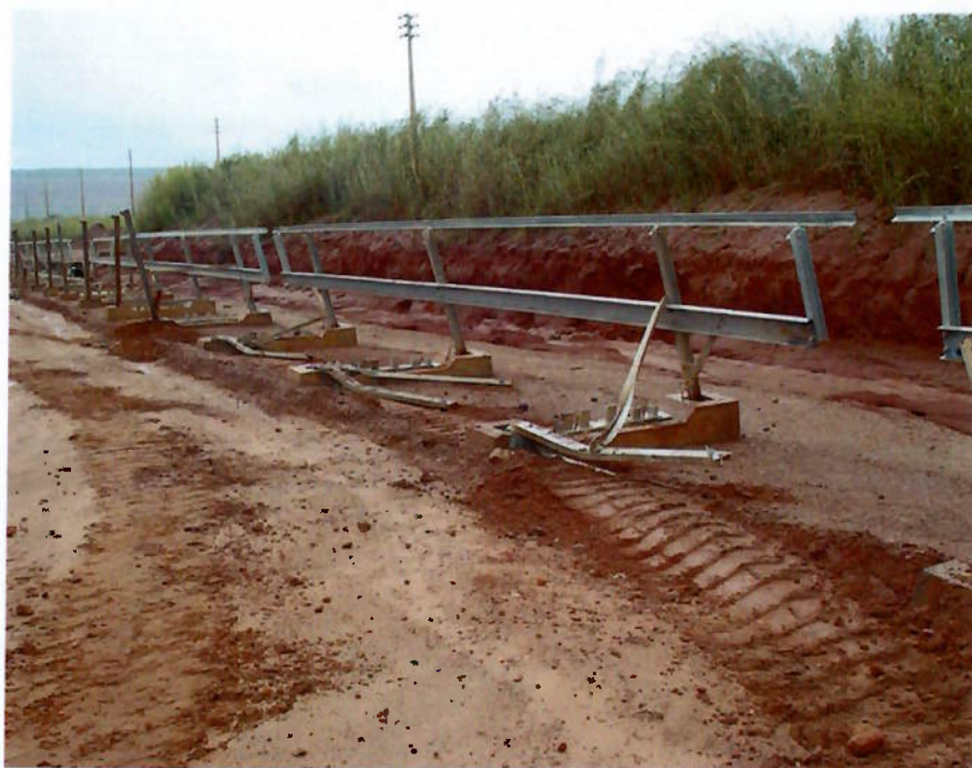
Figura 16 - Estrutura de base da correia transportadora
