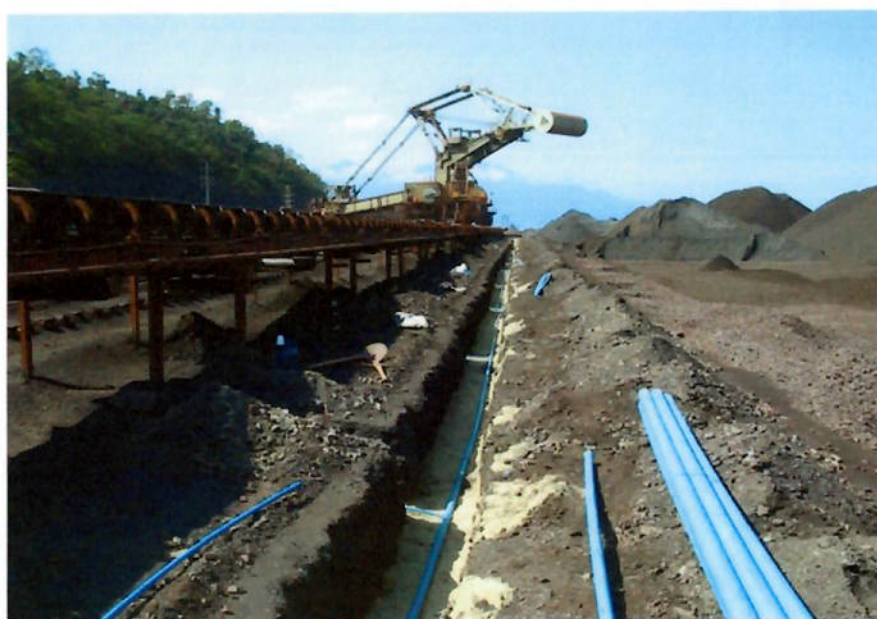
Figura 44- Rede hidráulica do sistema automatizado (FONTE: IRRICOM IRRIGAÇÃO E COMÉRCIO)
